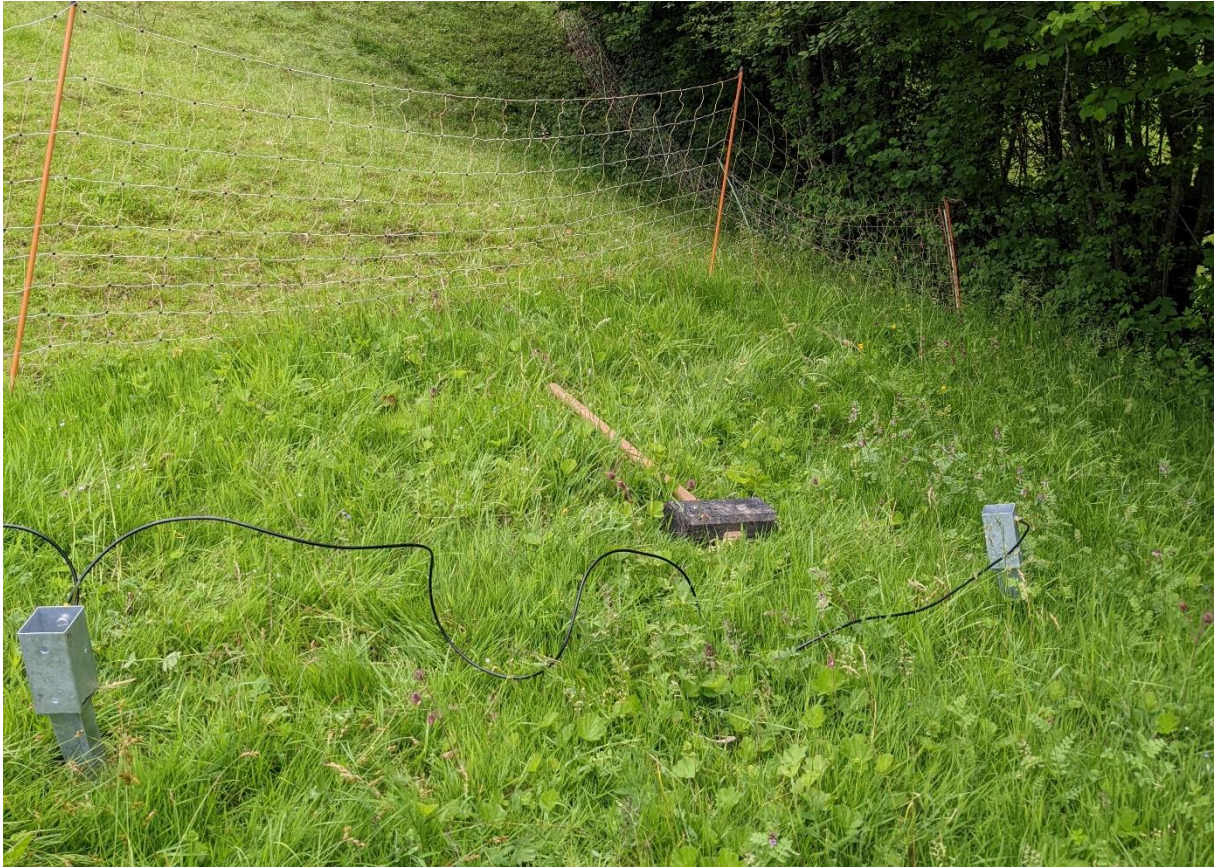
Abbildung 24: Zwei zusätzliche Erdungsstäbe wurden eingeschlagen, um die Erdung zu verbessern. Quelle: Eigenes Bild
